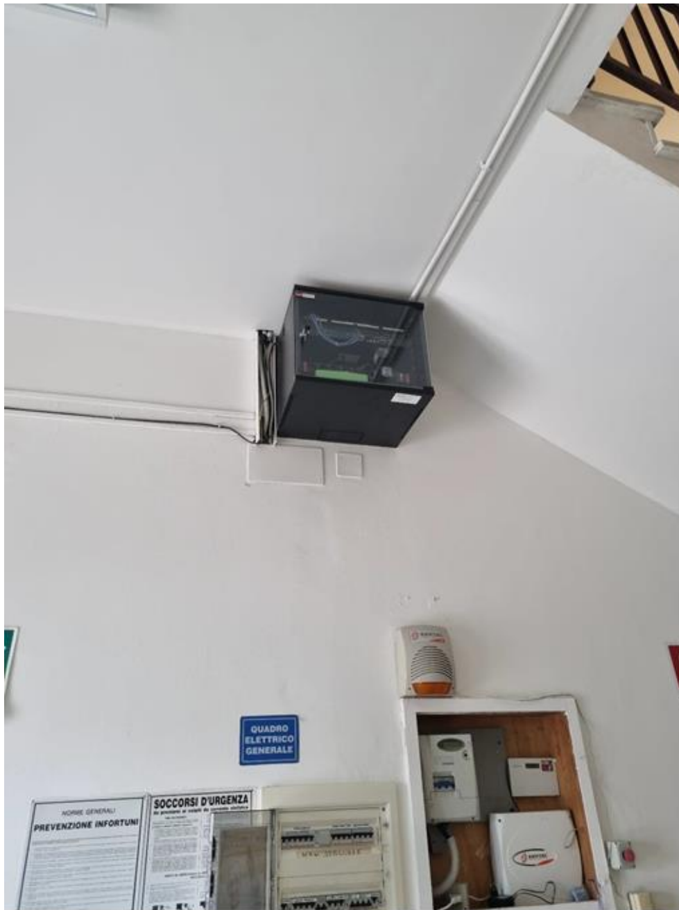
Fig. 10 Quadro elettrico generale plesso B (punto di consegna)
