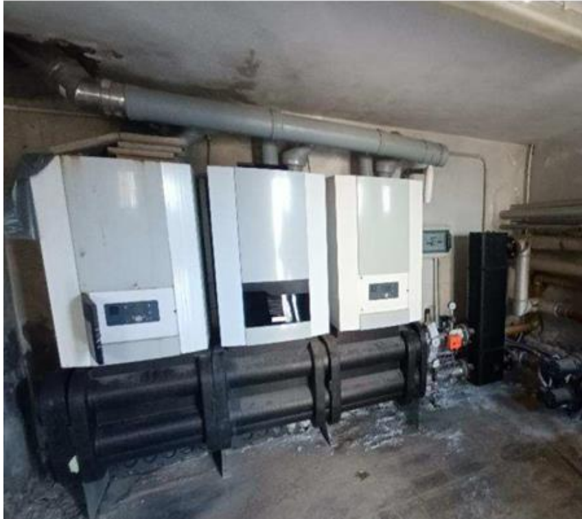
Fig. 22 Caldaia stato di fatto
