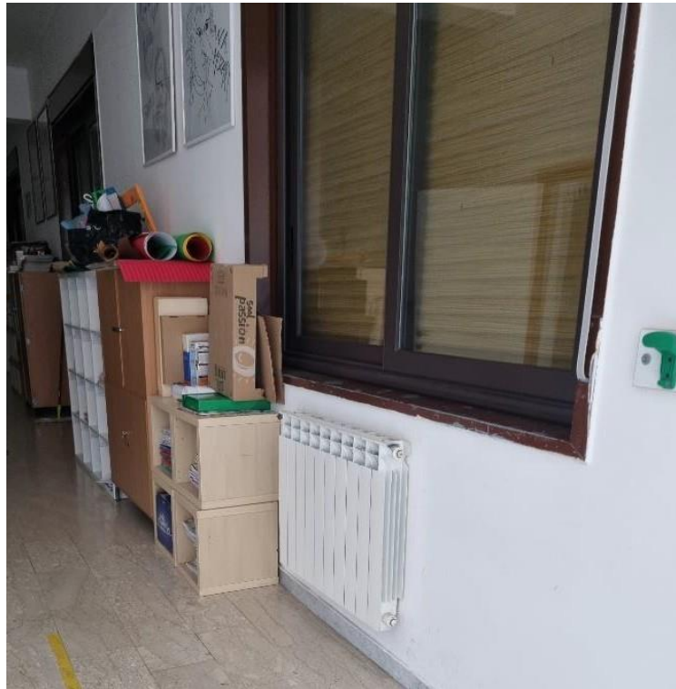
Fig. 23 Elementi radianti stato di fatto
