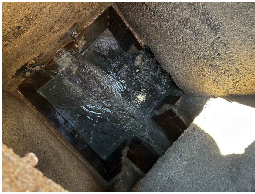
Foto scattata in fase di sopralluogo del pozzetto di recapito della condotta di smaltimento delle acque meteoriche, scarico a valle DNS800
